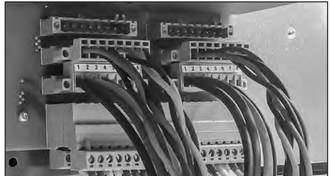
Figura 119. Un acercamiento de los conectores del tablero de la placa posterior del rack.
