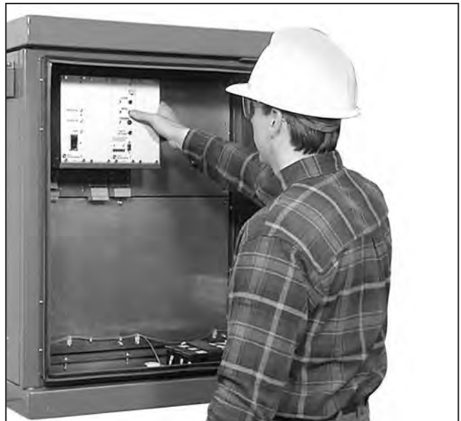
Figura 102. Un gabinete de baja tensión estilo bóveda mostrado con los aditamentos para una unidad terminal remota y comunicaciones.
