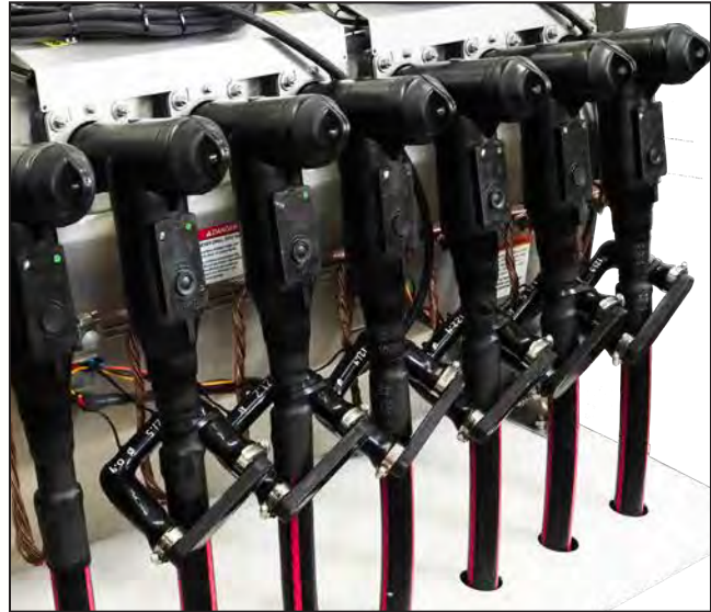
Figura 110. El cableado está sujeto a los sensores de corriente.
