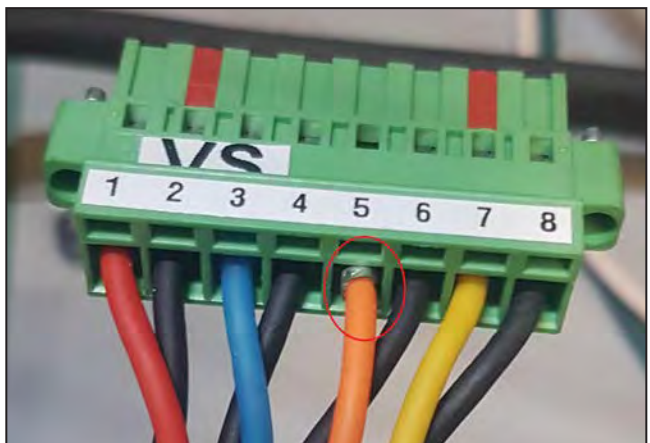
Figura 60. Ejemplo de conexión incorrecta que está salido.
