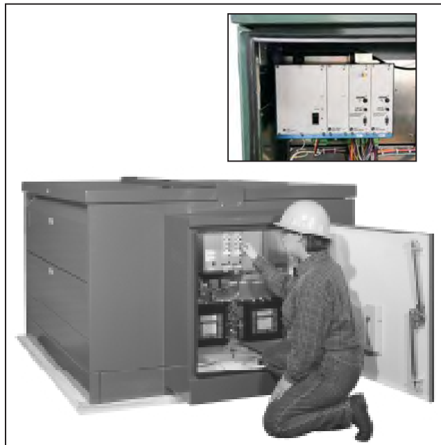
Figura 39. Ubicación de los controles de los moto operadores.
