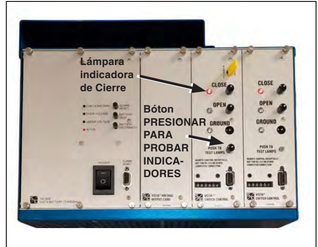
Figura 130. Pruebe los LED y lleve a cabo las operaciones de prueba.
