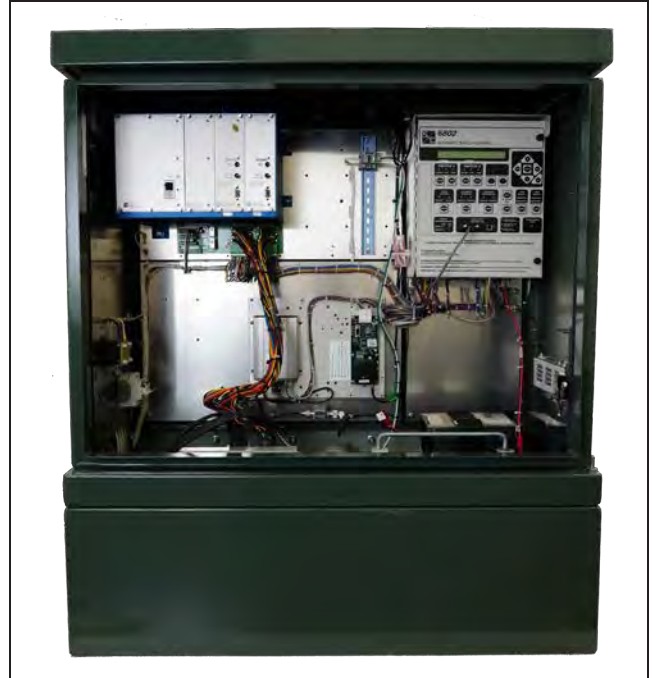
Figura 72. Se muestra un gabinete de baja tensión estilo bóveda con un Control Automático de Interruptores 6802 y suministros para comunicaciones.
