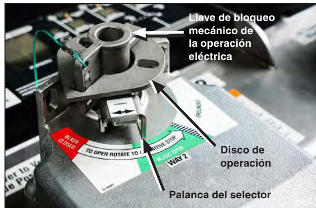
Figura 98. Indicación de la posición de “Cierre” del moto operador.
