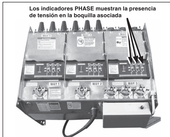
Figura 42. Cada indicador TENSIÓN es suministrado con tres indicadores PHASE—uno para cada fase.
