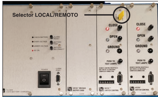
Figura 26. Estante de control del moto operador.
