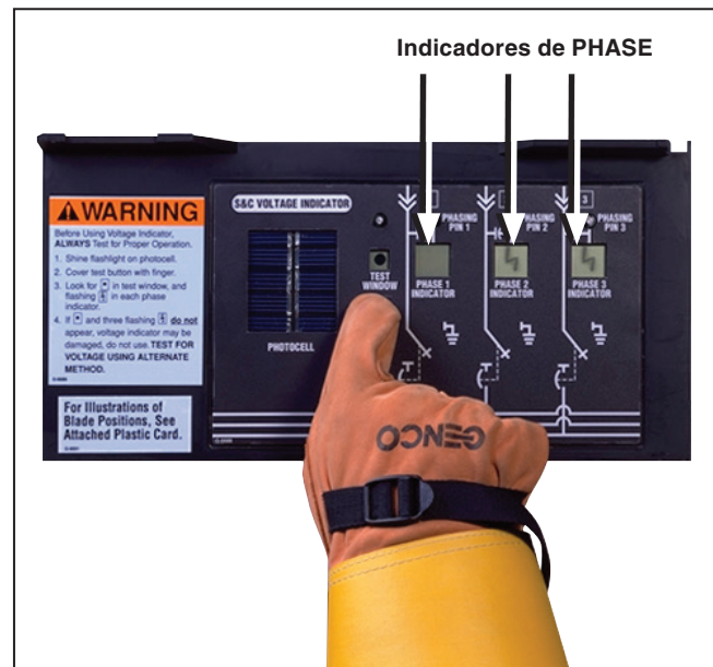
Figura 46. Si uno o más indicadores PHASE no muestra un relámpago intermitente durante la prueba, el indicador TENSIÓN puede estar dañado. Pruebe la tensión usando un método alternativo.
