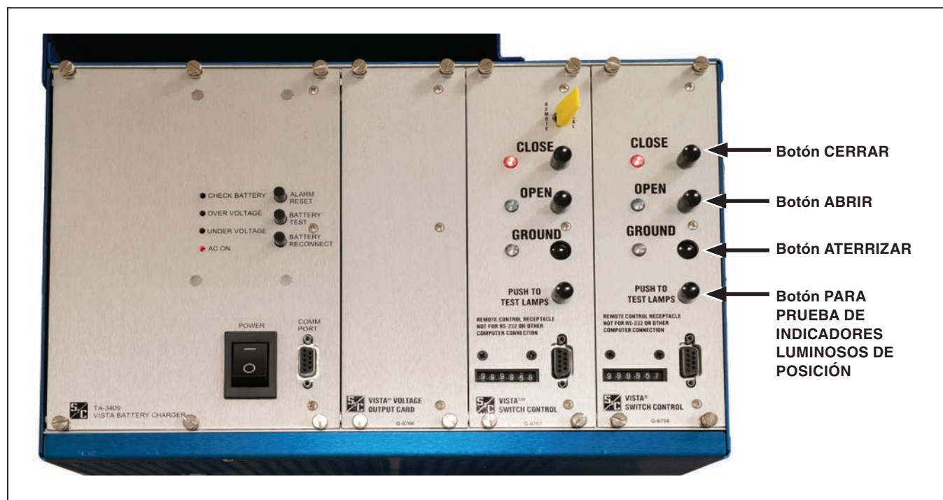
Figura 34. Botones del tablero de control del moto operador.
