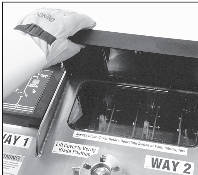
Figura 13. La cubierta para las ventanillas se levanta para ver la posición de la cuchilla desconectadora del seccionador o interruptor de fallas.
