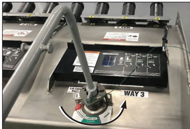
Figura 17. Operação da Posição Aberta para a Posição Aterrada.
