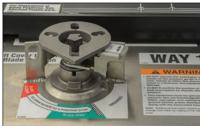
Figura 16. Interruptor de carga ou interruptor de falta na posição Aberta.
