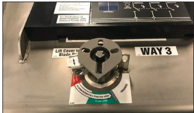
Figura 20. Interruptor de carga ou interruptor de falta na posição Aberta.
