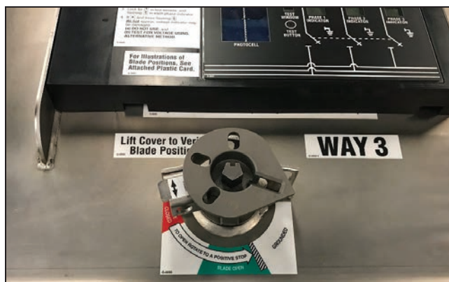
Figura 18. Interruptor de carga ou interruptor de falta na posição Aterrada.
