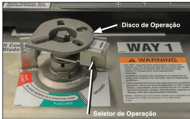
Figura 11. Na posição extrema direita, o seletor de OPERAÇÃO permite operação entre as posições Fechada e Aberta.
