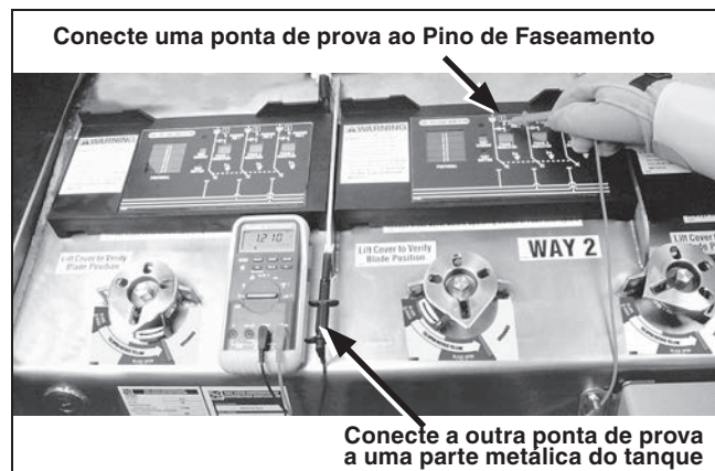
Figura 40. Aterramento do voltímetro.
