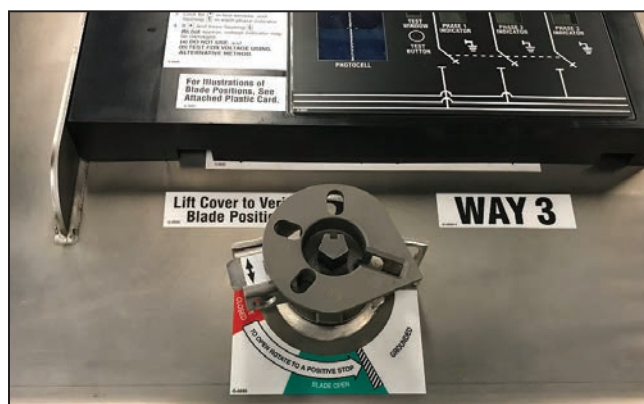
Figura 18. El interruptor seccionador de carga o el interruptor de fallas en la posición de Aterrizado.
