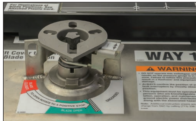
Figura 16. El interruptor seccionador de carga o el interruptor de fallas en la posición Abierto.
