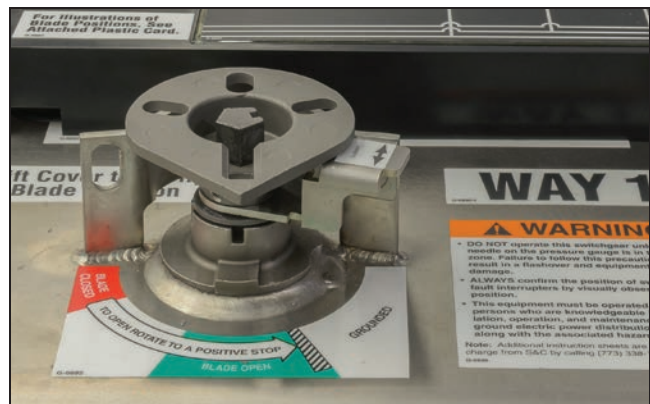
Figura 25. El interruptor de fallas en la posición Abierto.
