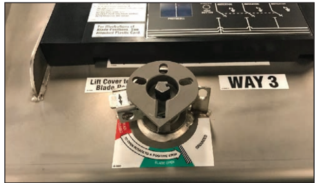
Figura 20. El interruptor seccionador de Carga o el interruptor de fallas en la posición Abierto.
