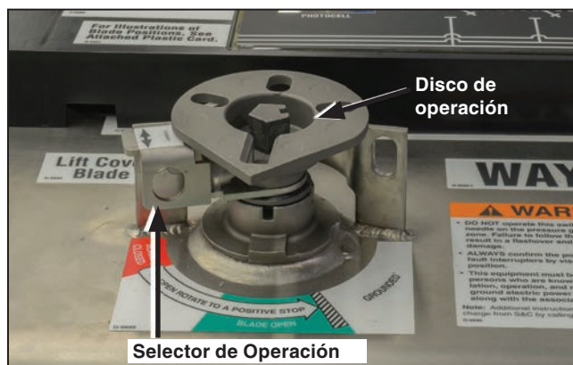
Figura 13. En la posición extrema izquierda, el selector de OPERACIÓN permite la operación entre las posiciones Abierto y de Aterrizado.
