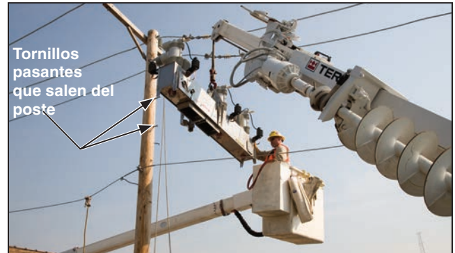
Figura 7. Montaje apropiado de un interruptor de fallas IntelliRupter.
