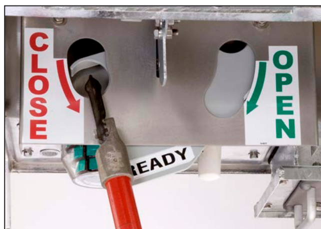
Figura 27. Cierre de las cámaras interruptivas con una pértiga.
