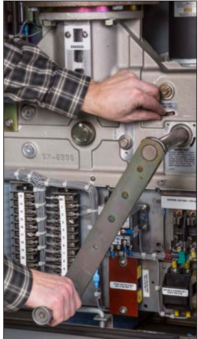
Figura 31. Utilice la palanca de carga manual para recargar los resortes de apertura y cierre y para abrir la cuchilla desconectadora.
