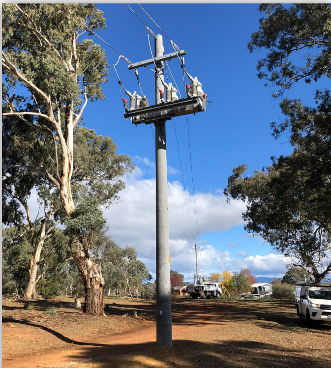
FIGURA 2. Um interruptor de falta IntelliRupter instalado em um alimentador da Evoenergy em uma área sujeita a incêndios florestais.
