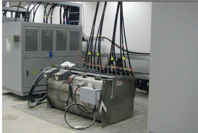
Instalação de uma unidade do Sistema de Distribuição Subterrânea Vista Supervisão Remota.
