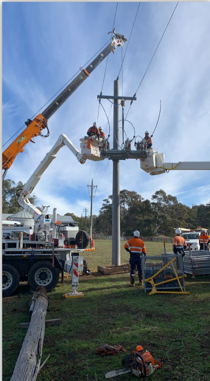
FIGURA 1. Instalación de un interruptor de fallas IntelliRupter® con el nuevo algoritmo de falla a tierra de alta impedancia.
