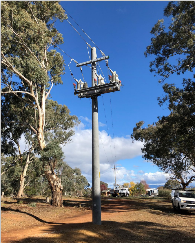
FIGURA 2. Un interruptor de fallas IntelliRupter instalado en un alimentador de Evoenergy en una zona propensa a los incendios forestales.
