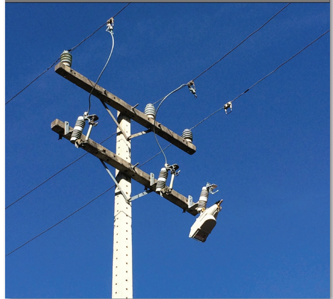
Una instalación de un reconnector TripSaver II en Paraná, Brasil.
