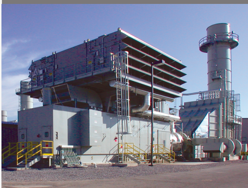
40-MW gas-turbine generation “peaker” plant.
