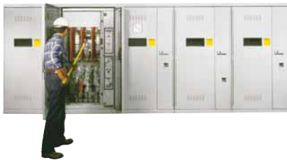
...En los Tableros de Distribución con Gabinete Metálico Tipo Metal Enclosed de S&C
