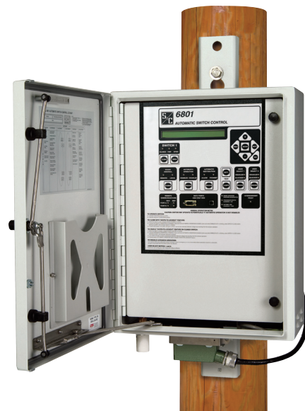
Control de Interruptor Automático 6801 presentando el software del IntelliTeam II.
